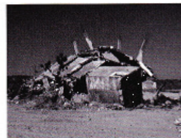
N3004-99 Quartier: Jabalya Nord; voisinage: /; date de destruction: 8 janvier 2009; méthode de destruction: bombardement; date d'inspection: 29 avril 2009; état du bâtiment: ruines.
