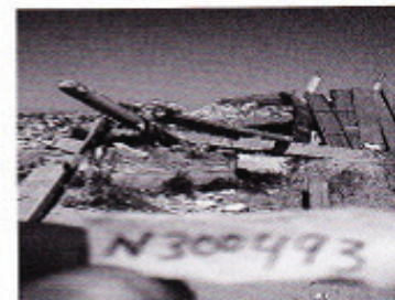
N3004-93 Quartier: Jabalya Nord; voisinage: As-Salam; date de destruction: 15 janvier 2009; méthode de destruction: bulldozer; date d'inspection: 29 avril 2009; état du bâtiment: ruines.
